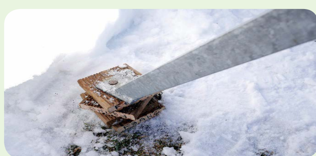
Le niveau est partiellement rattrapé avec des cales en bois...
