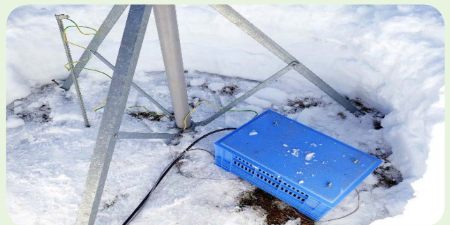
Tout est mis en place au pied de l'antenne: la boîte d'accord et le piquet de terre...
